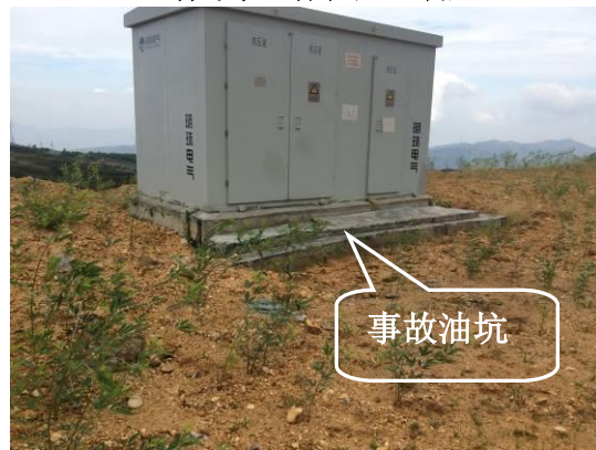
35kV 箱式变压器事故油池
