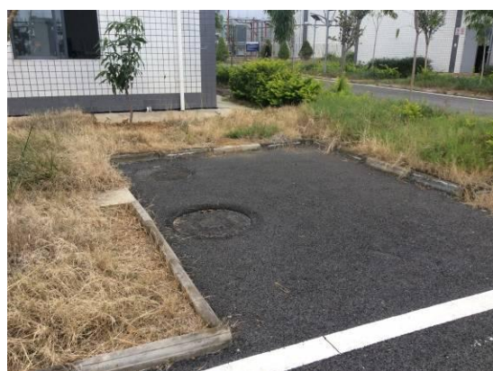
生活污水预处理池
