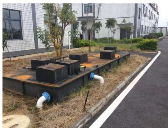
生活污水一体化处理装置
