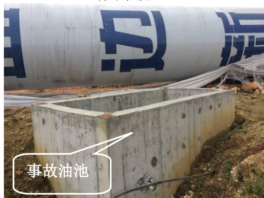
35kV 箱式变压器事故油池
